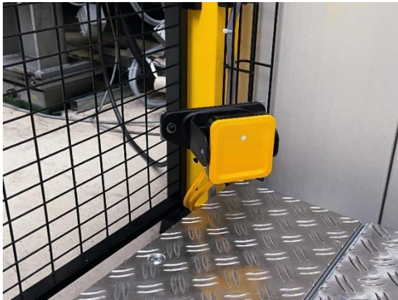
図2: F_Weidplas_PSEnradar_IMG_7198_cold1 (© Pilz GmbH & Co. KG)
